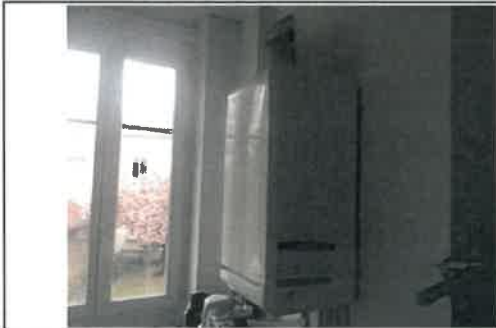
Photo n° PhGaz001 Localisation : Cuisine Chaudière DE DIETRICH (Type : Raccordé) Localisation sur croquis : Point001
